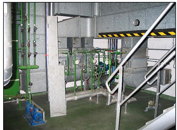
De koeling en klimatisatie – foto H. de Cuyper.
